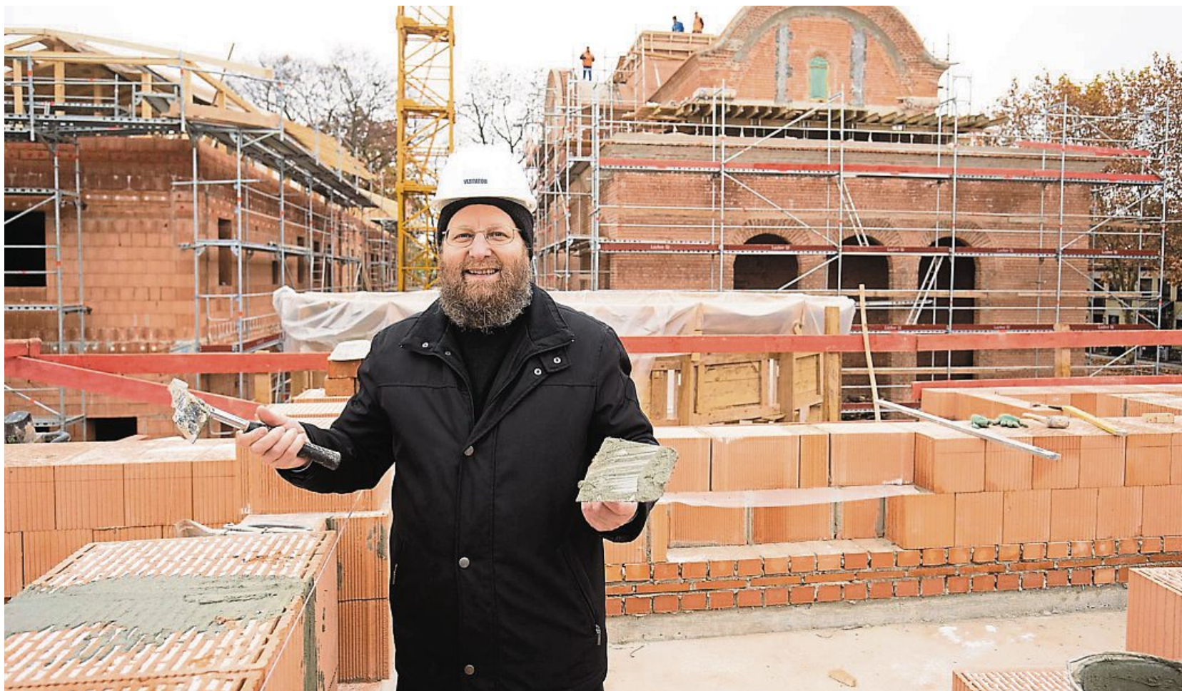
Noch Baustelle, bald Bischofssitz: Weihbischof Sofian freut sich auf das neue Kirchenzentrum der rumänisch-orthodoxen Metropole. FOTO: OLIVER BODMER
